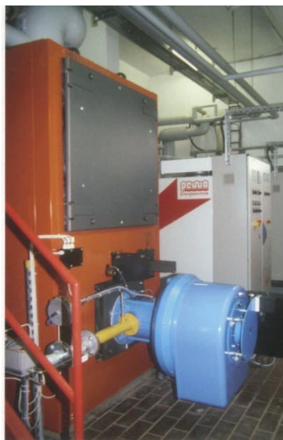
Mit Anlagen-Contracting saniert: Moderne Heizzentrale im JAZ
