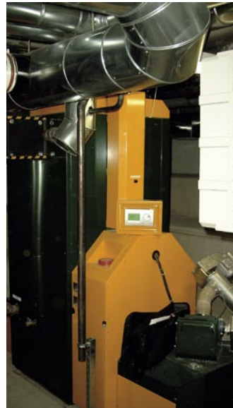
Pelletkessel im Keller
