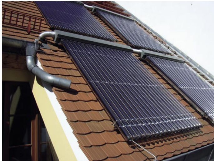
Vakuum-Röhrenkollektoren, geschlossene Dachhaut, rückbaubare Anlage
