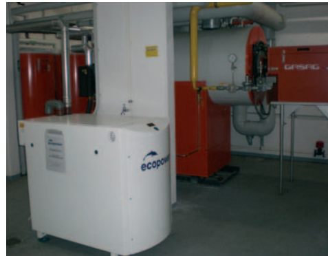
Der Einsatz eines BHKW vom Typ ecopower (5 kW el; 13 kW th) im Keller eines Mehrfamilienhauses in der Spandauer Pfarrer-Theile-Str. führt zu Energieeinsparungen und entlastet die Umwelt.
