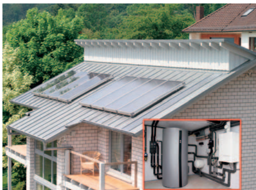
Hoch effiziente Brennwertgeräte ergänzt mit Solarthermie: Eine solche Kombination verbraucht bis zu 40 Prozent weniger Heizöl als ein Standard- oder Niedertemperaturkessel der ersten Generation. In gleicher Größenordnung sinken die brennstoffspezifischen CO 2 -Emissionen.
