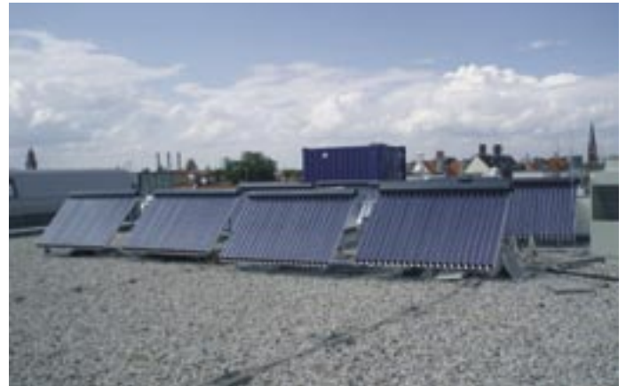
Abb. 3: Die Solare Kühlanlage auf dem Dach des Ärztehauses Bundesallee 104/105 in Berlin Steglitz
