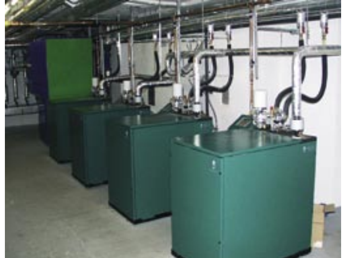
Mini-BHKW auch „in Reihe schaltbar“
